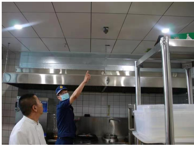
为进一步加强燃气使用领域消防安全管理,近日,宁夏消防救援大队深入开展燃气消防安全专项检查,督促各场所要加强消防安全管理,严格落实消防安全责任制,排查检查各类火灾隐患,确保单位消防安全。 本报通讯员 吕磊 摄
