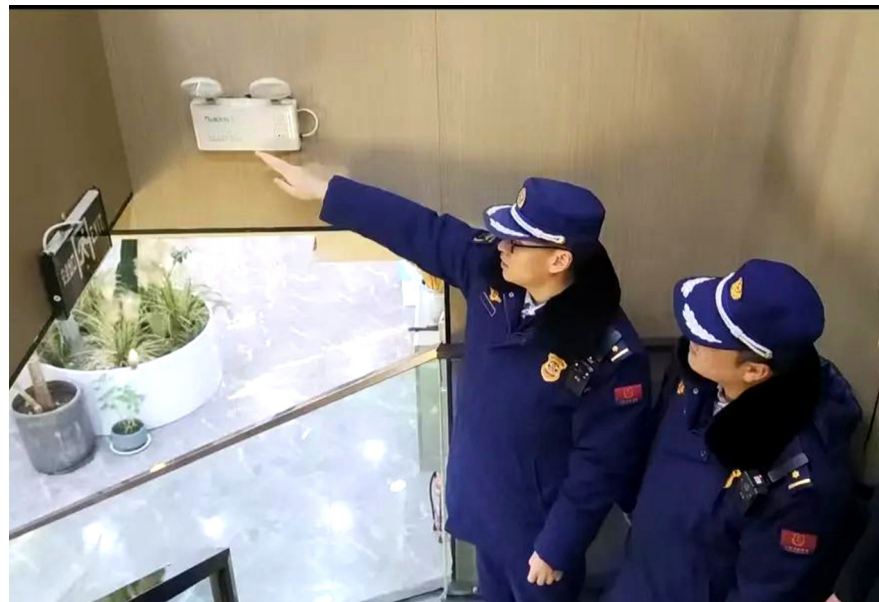
西吉一家餐厅疏散楼梯间的应急照明灯和安全出口指示标志损坏。
