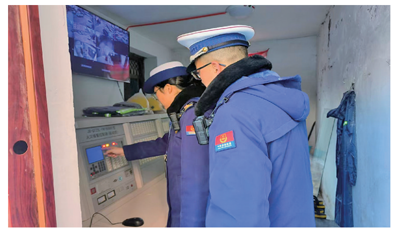
消防监督员查看消防控制室运行情况。
