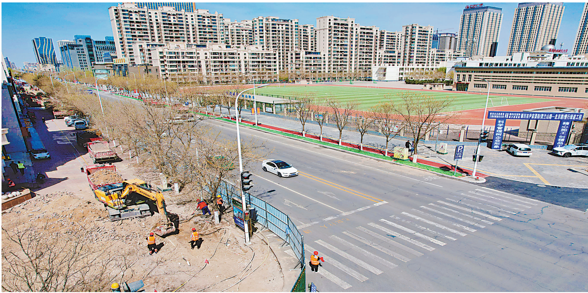
4月5日,银川市金凤区尹家渠北街(北京路—上海路)段,工人和工程车辆正在进行道路施工。尹家渠北街改造工程将机动车道路面从4车道拓宽为6车道,并将原有的非机动车道改至两侧路基上,以提高交通高峰期通行率和安全性。目前,该路段东侧道路已施工完毕投入使用,西侧道路正在加紧施工。 本报记者 马楠 摄
