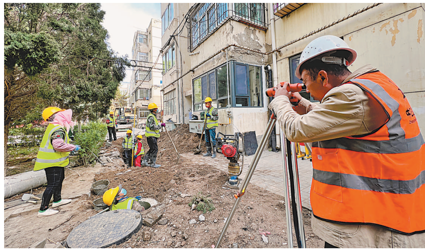
近日,工人在银川市兴庆区福川苑小区进行小区排水管道改造施工。据了解,2022年兴庆区计划投资5.44亿元改造老旧小区99个,涉及416栋楼17823套住宅,总建筑面积137万平方米。
