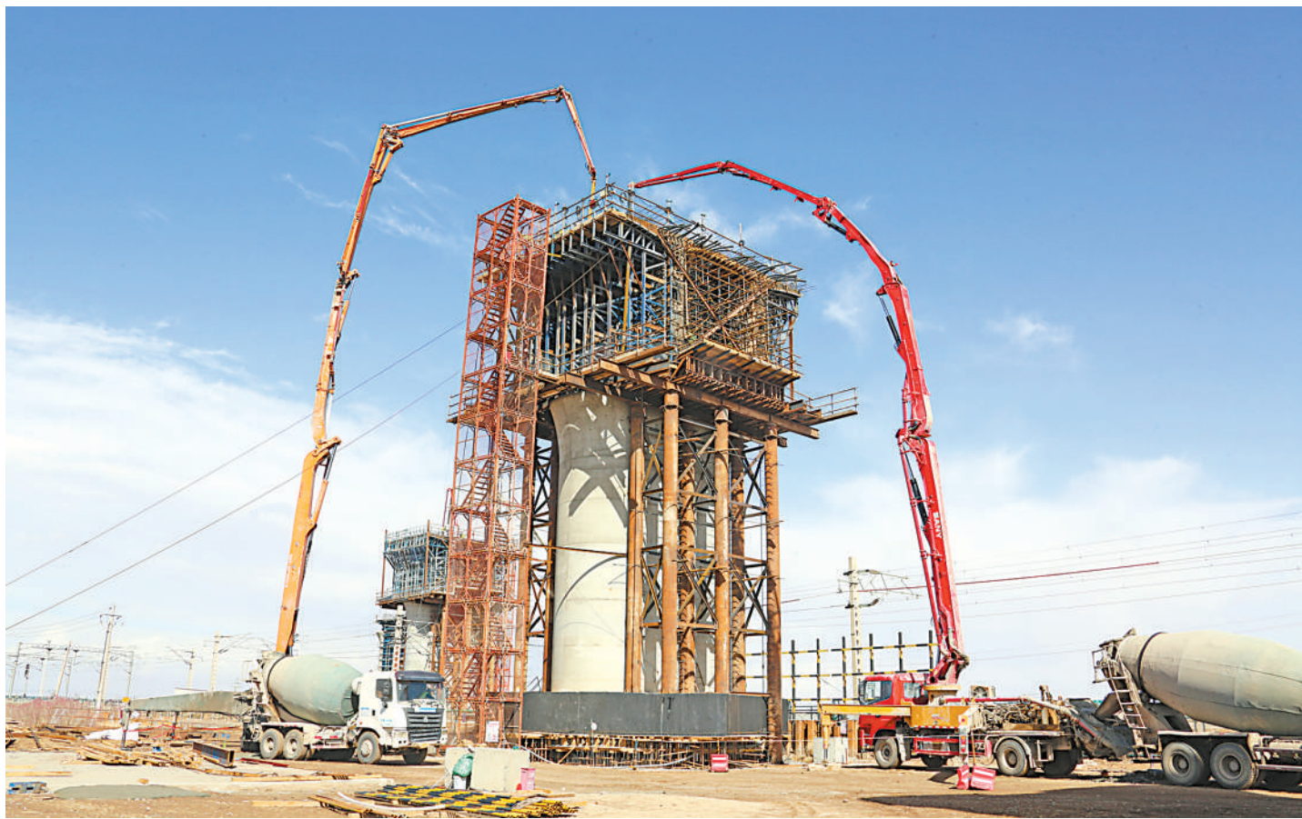
包银铁路银川至惠农段站前工程上跨包兰铁路80米转体桥施工现场。
