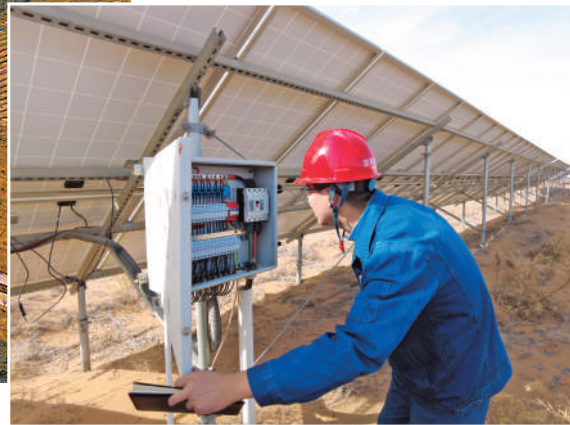
↓光伏电站值长正在检查汇流装置。
