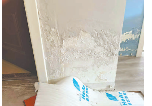
水管漏水造成墙面起皮。
