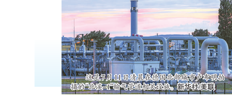
这是7月11日清晨在德国北部城市卢布明拍摄的“北溪-1”输气管道相关设施。 新华社美联
