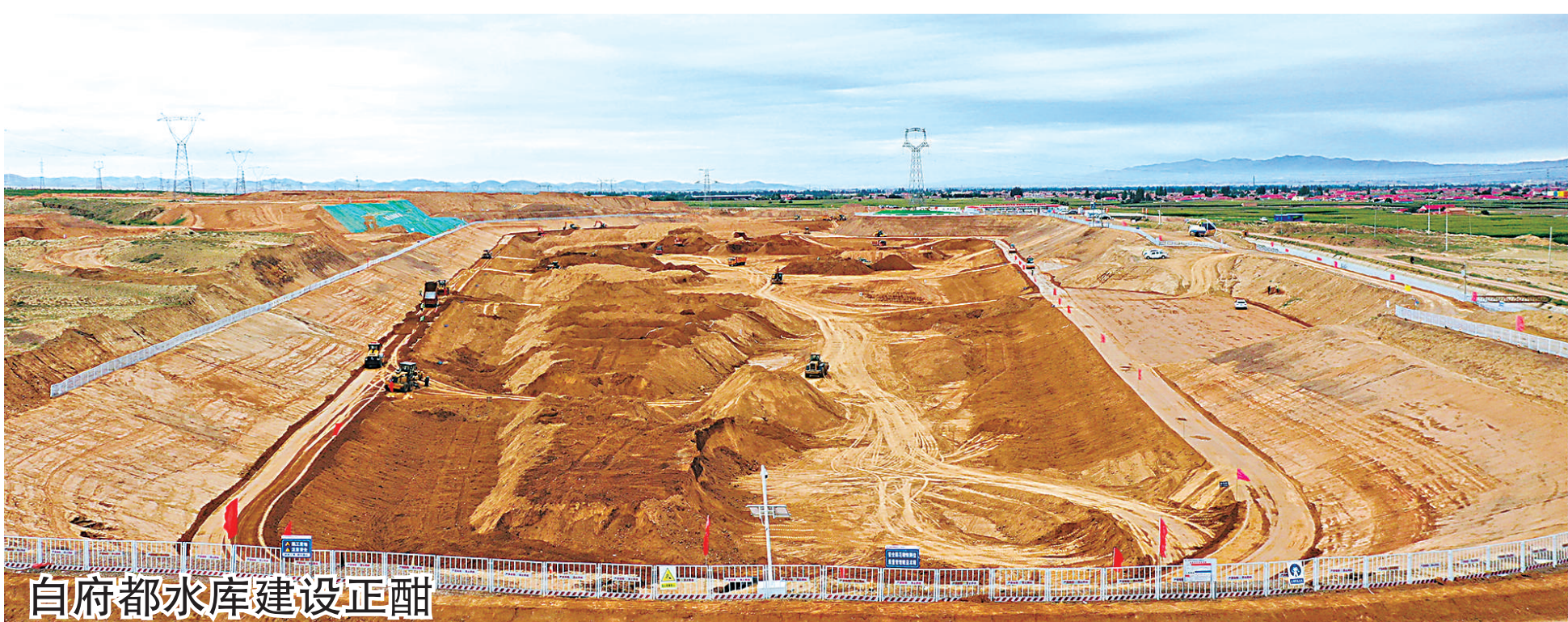
自府都水库建设正酣 7月21日,固海扩灌扬水更新改造工程白府都水库工程施工现场,挖掘机、自卸汽车、压路机等施工机械来回穿梭。白府都水库是固海扩灌扬水更新改造工程重要调蓄水库之一,总投资7400万元。工程建成后将进一步提高固海扩灌系统供水保障能力,有效解决同心县河西镇旱天岭0.5万亩高效节水灌溉用水困难问题。
