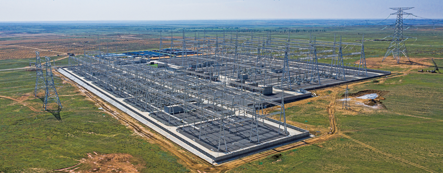
青山750千伏输变电工程。
