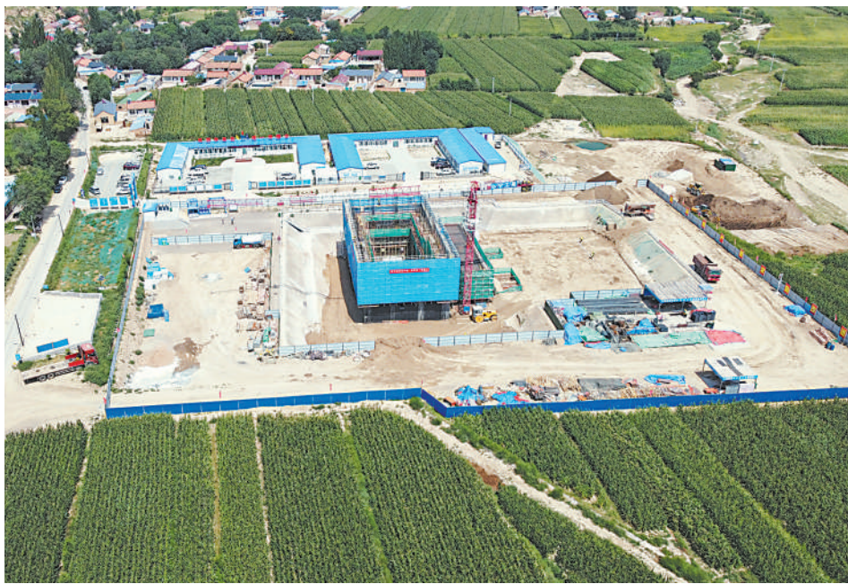
西吉供水工程已完成何家沟一泵站主体工程、一泵站机电安装工程和一泵站压力管线工程,二泵站、二泵站压力流管线、高位水池、重力流管线工程正在建设中。本报记者 裴云云 摄
