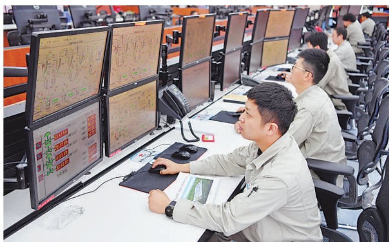
国家能源集团宁夏煤业有限责任公司煤制油分公司中央控制室,工作人员在监控生产数据。
