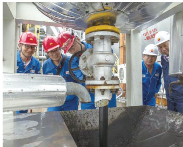
6月10日，常压电脱盐废水除油除砂装置正式建成投运。经过3个月的运行验证，废水中的油含量和化学需氧量明显降低，环保效益和经济效益显著。“十四五”以来，公司以创新驱动战略为引领，推进发展质量和效益效率全面提升。
