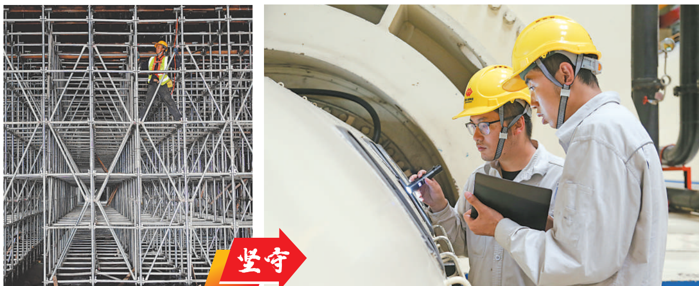
10月2日,银川市贺兰山路与民族街交叉口快速化改造工程施工现场,工人坚守岗位,确保工程进展顺利。 本报记者 王晓龙 摄
