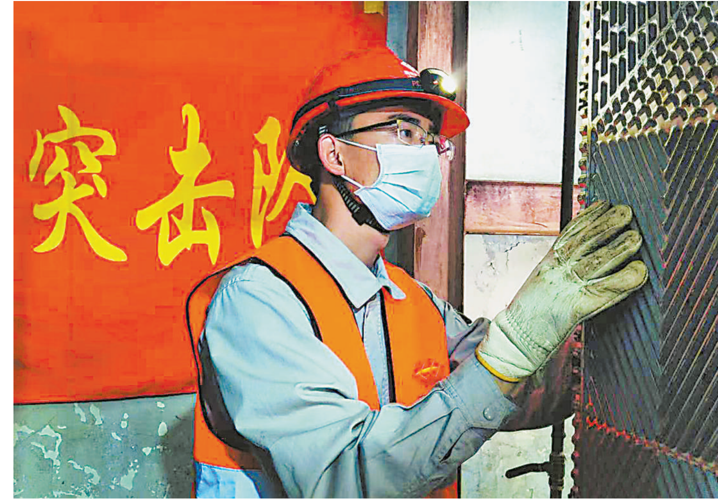
10月31日,工作人员监测管网运行情况。国能宁夏煤业有限公司从10月18日开始进行预供热升温工作,并根据外界环境气温的对应曲线严格开展生产负荷调度,调整入户温度,随时进行水力平衡和热力平衡调整。 本报记者 杨娟 摄
