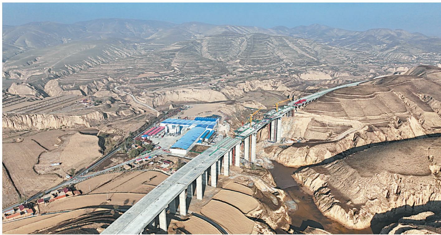
11月1日,由中铁十八局集团承建的银昆高速公路LJ08-2标段控制性工程——油坊梁大桥主桥波纹钢板悬臂现浇梁左幅完成合龙。 本报记者 赵磊 摄
