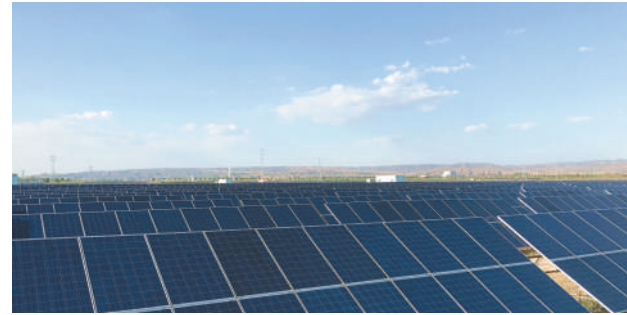
固原头管光伏电站。
