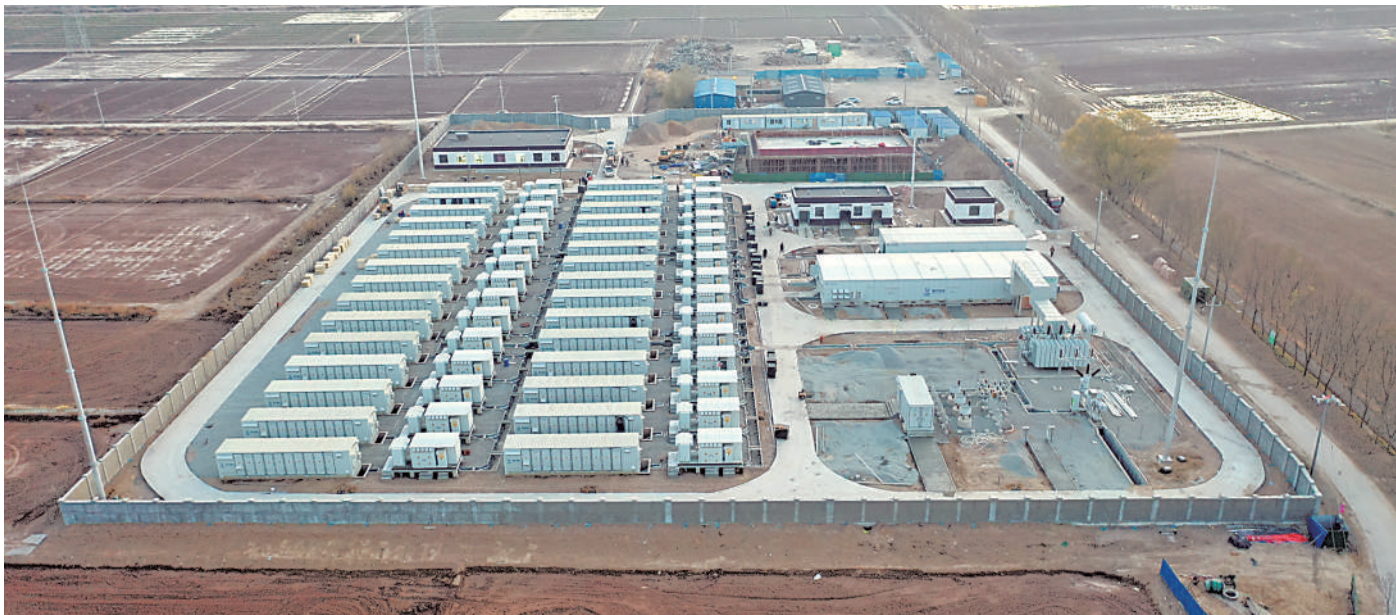
宁储利通区板桥100兆瓦/200兆瓦时共享储能电站项目建设现场。
