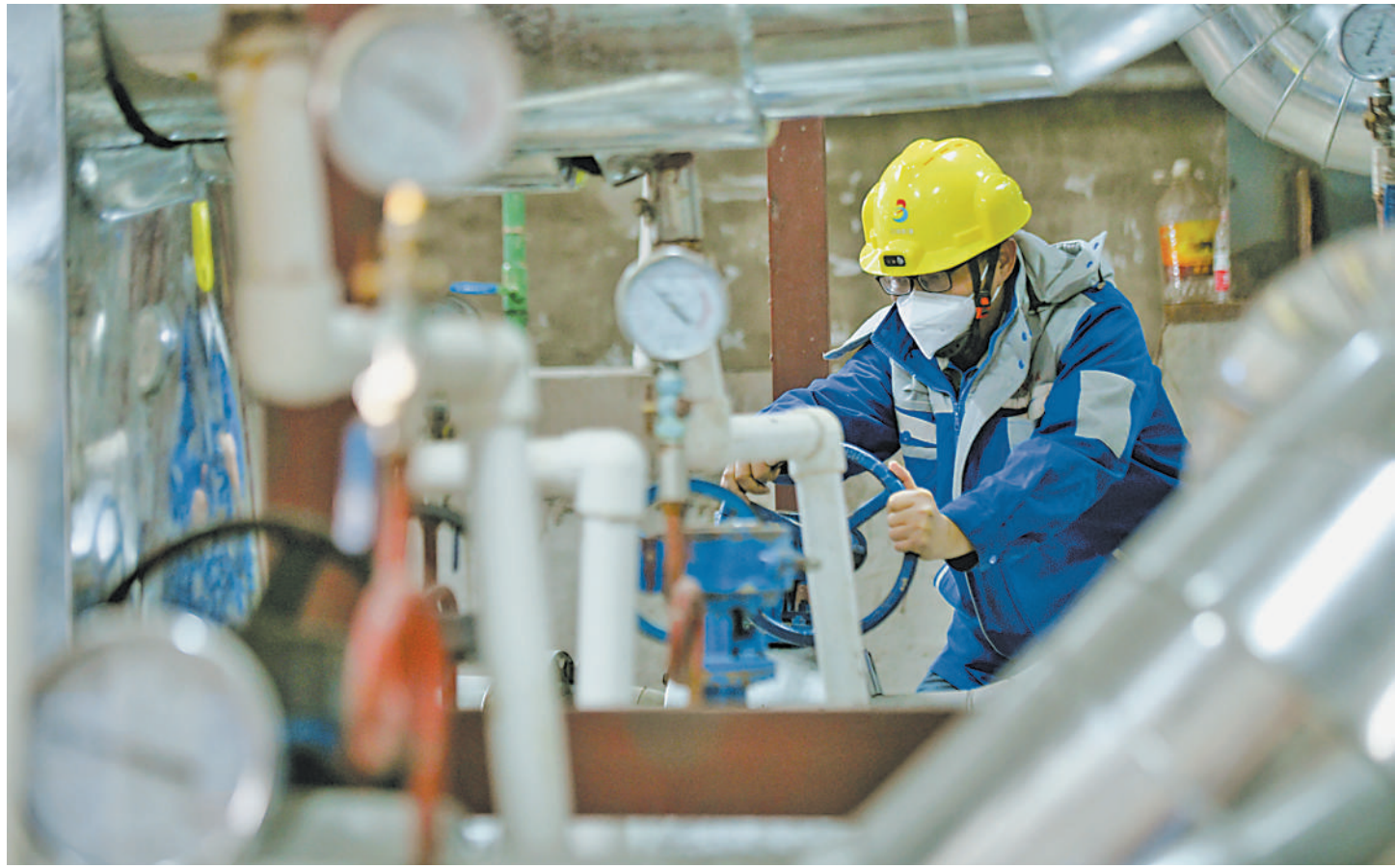
11月28日,宁夏百新能源科技发展有限公司丰登一号换热站内,工作人员进行设备巡检。当日,受强冷空气影响,我区进入“速冻”模式,寒流来袭,供热企业采取多种举措,应对低温寒冷天气,保障居民温暖过冬。
