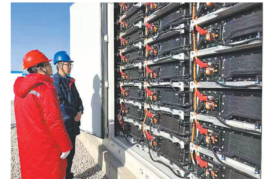
宁夏穆和200兆瓦/400兆瓦时新能源储能电站项目储能设备一角。本报记者 鲁延宏 摄
