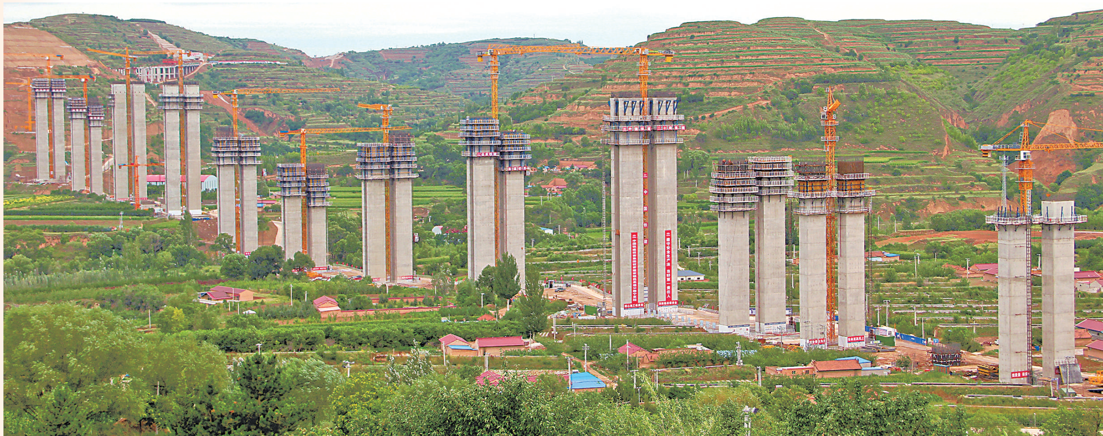
银(川)昆(明)高速公路全线控制性工程——友联红河特大桥主体工程建设规模显现,山间一座座高低起伏的桥墩,如同跳动的音符。 本报记者 左鸣远 摄
