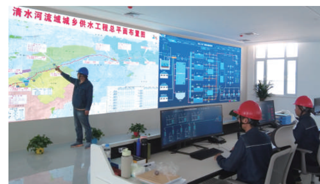
清水河流域城乡供水工程综合自动化工程调度中心。
