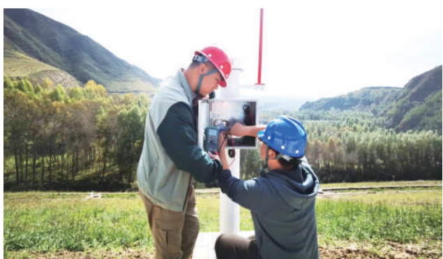
青海省西宁市湟中区云谷川水库大坝安全监测系统实施现场。
