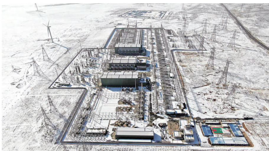
宁夏灵武—浙江绍兴±800千伏灵绍特高压直流输电工程送端——灵州换流站。
