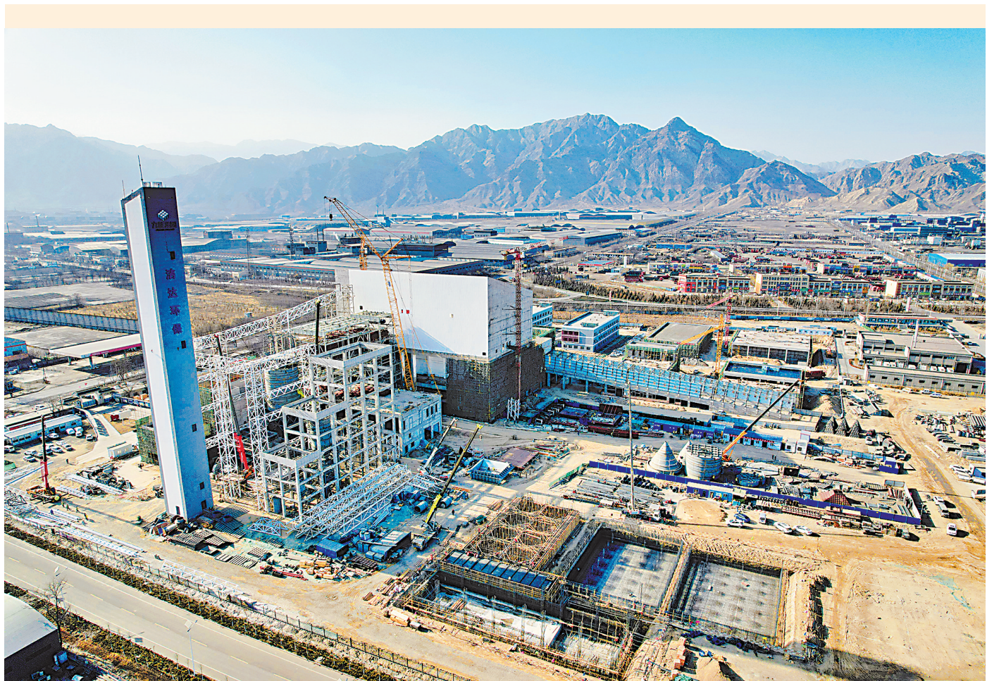
今年的政府工作报告指出,加强城乡环境基础设施建设,持续实施重要生态系统保护和修复重大工程。3月7日,石嘴山市生活垃圾综合处置项目施工现场机声隆隆,项目正在快速推进。该项目是自治区“十四五”规划重大工程,项目建成运行后,可加速推进石嘴山市生活垃圾分类处置和资源化利用。(本报记者 马楠 王洋 摄)
