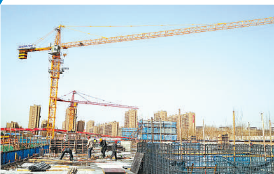
银川市西夏区南部片区排水防涝设施雨水调蓄池项目(二期)建设现场。
