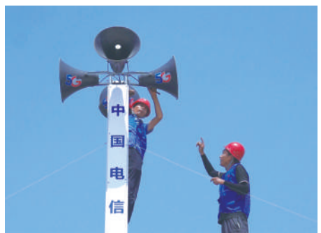
宁夏电信装维人员在贺兰县欣荣村调试天翼大喇叭,助力乡村治理。
