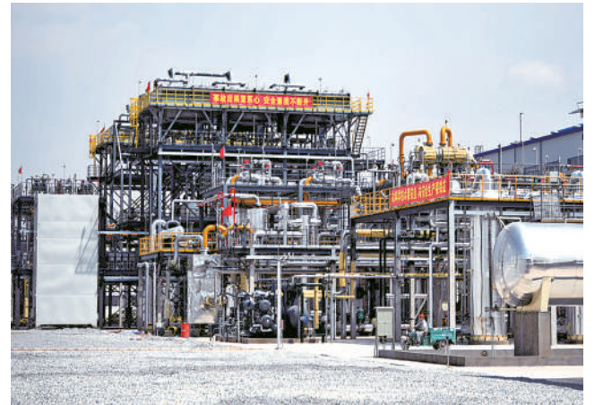
盐池县宁夏深燃众源天然气有限公司全部投产运行后,LNG(液化天然气)总产能将达到日处理天然气300万立方米、年产LNG60万吨。
