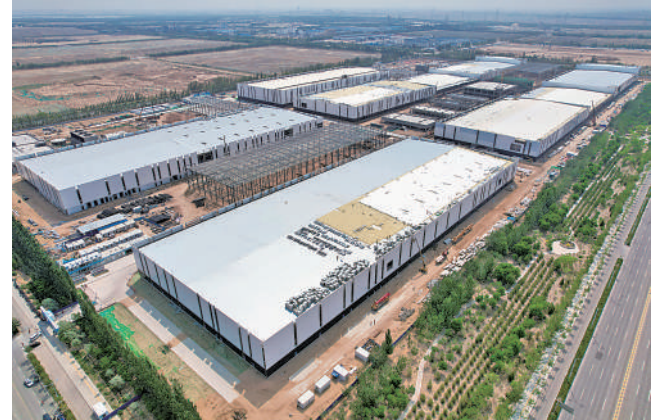
宝丰电池及储能集装系统示范项目中试车间与电芯厂房在高效建设中,该项目填补了宁夏地区新型储能产业空白。
