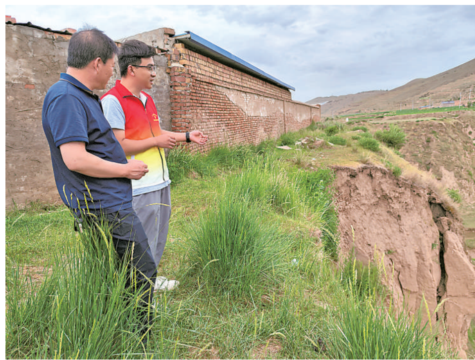
西吉县王民乡九年一贯制学校校长古希义(左)向宁夏国土资源调查监测院工程师张刚介绍边坡崩塌情况。
