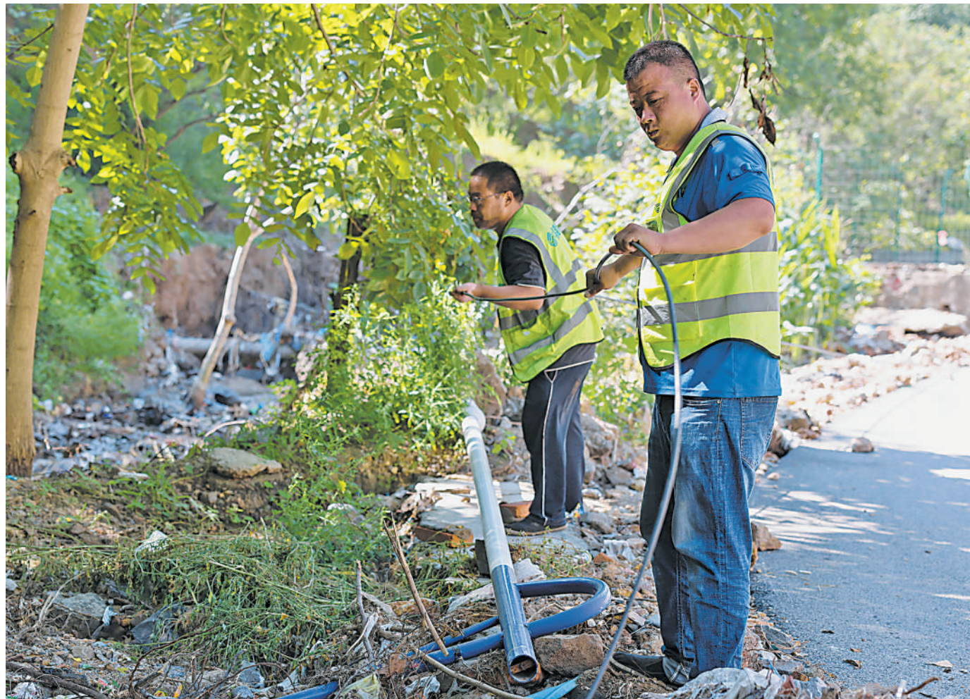
8月16日,通信公司施工人员在河北涞水县九龙镇大泽村抢修通讯设施。近日,受台风“杜苏芮”影响,河北省保定市涞水县遭遇强降雨。当地成立灾后重建领导小组,统筹开展拉网式受灾情况排查,谋划编制灾后重建规划和方案。 连日来,当地积极组织力量开展灾后抢修重建工作,加快修复道路、供电、供水和通信等设施,做好环境消杀、灾后防疫,组织开展灾后清淤、灾毁房屋保险评估等工作,保障受灾群众生活,并积极引导群众生产自救,争取尽快恢复正常生产生活秩序。 新华社发
