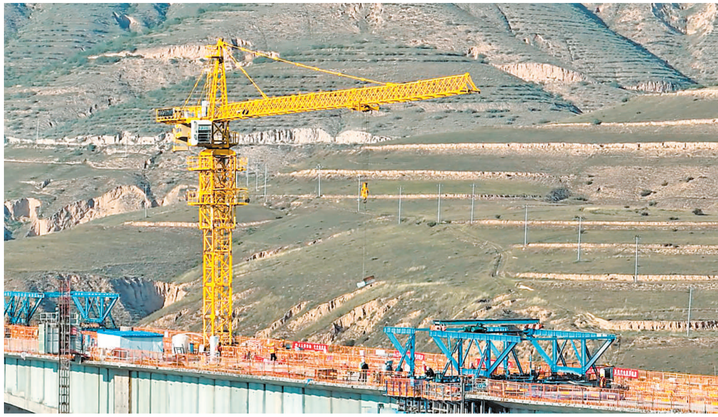
8月30日,银昆高速公路(宁夏段)重点桥梁工程——穿越湿陷性黄土地带的刘家咀子大桥顺利合龙,为2024年全线建成通车奠定了坚实基础。银昆高速公路(宁夏段)总投资约261亿元,是迄今我区单体投资规模最大的交通项目。 本报记者 陈瑶 摄
