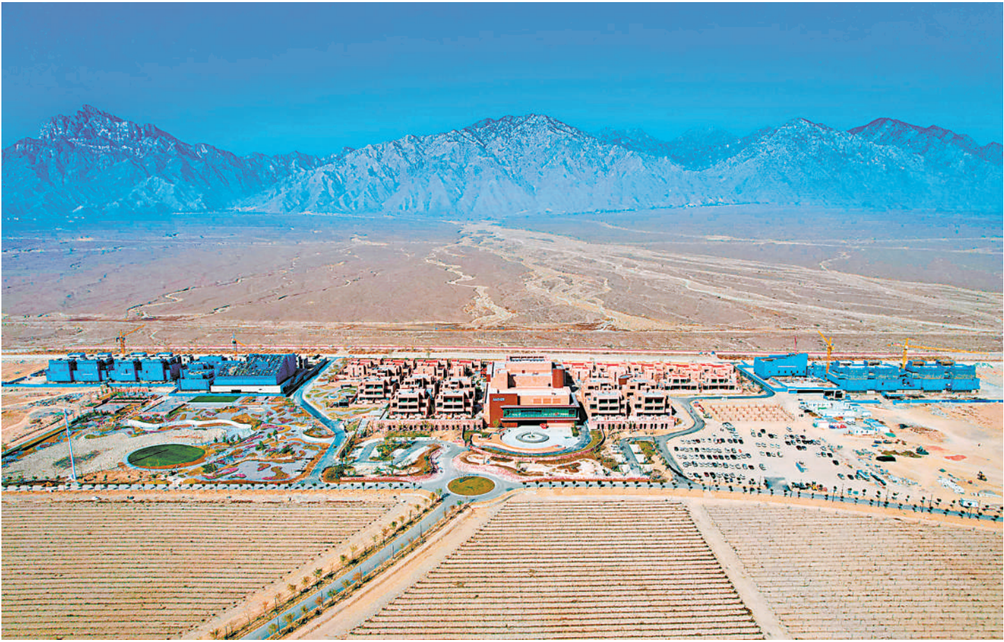
11月6日,位于贺兰山东麓葡萄酒产区金山片区的图兰朵葡萄酒小镇项目施工现场,一派繁忙景象。作为宁夏“六个一百”重大项目之一、宁夏葡萄酒产业“十四五”时期首批重点项目、银川市重点建设项目、贺兰县葡萄酒产业“一号工程”——图兰朵葡萄酒小镇项目于2022年3月开工,占地面积3300亩,总投资25亿元,预计分三期完成建设。据项目相关负责人介绍,作为小镇的首个建设项目,酒店深度融入当地风土人情、传统文化及旅游特色,打造亲近自然的生活体验场景,重点展现葡萄酒文化和贺兰山文化。目前,酒店一期已具备入住条件。 本报记者 王婧雅 马楠 摄
