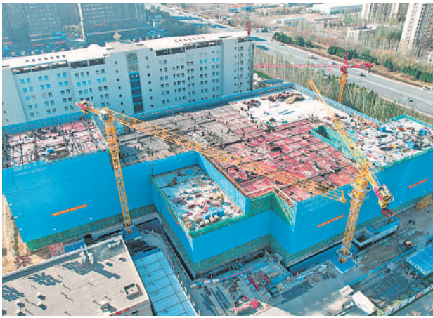
11月18日,北京大学第一医院宁夏妇女儿童医院在建项目加紧施工,计划明年5月全面封顶。该医院是我区第一个国家妇儿区域医疗中心,建成后总床位数达1000张。截至目前,工程已完成住院部主体六层、科研教学楼主体五层建设。 本报记者 左鸣远 摄
