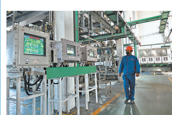
11月29日,宁夏东吴农业股份有限公司技术人员对生产设备进行巡检。该公司生产装置逐步完成了全流程自动化改造工作,实现了安全生产稳定运行。 本报记者 王猛 见习记者 李雅蓉 摄
