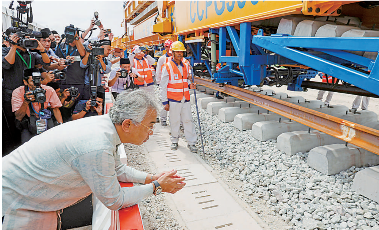
12月11日，在马来西亚彭亨州首府关丹市，马来西亚最高元首阿卜杜拉观看铺轨。由中国交通建设集团有限公司承建的马来西亚东海岸铁路(马东铁)项目轨道工程启动仪式12月11日在马来西亚彭亨州首府关丹市举行。马来西亚最高元首阿卜杜拉在仪式上正式启动马东铁项目轨道铺设。(新华社发)
