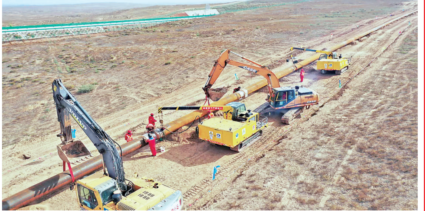
12月29日,青石峁气田外输管线工程整体机械完工。(图片由受访单位提供)
