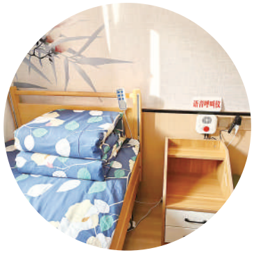
崇安社区引进的康养项目一键语音呼叫仪安装可供居民选择。
