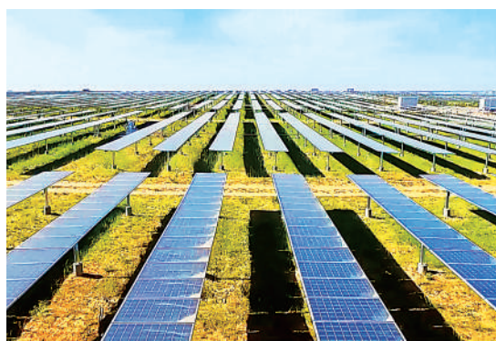
光伏基地内一块块蓝色光伏板,源源不断地输送绿色电能。
