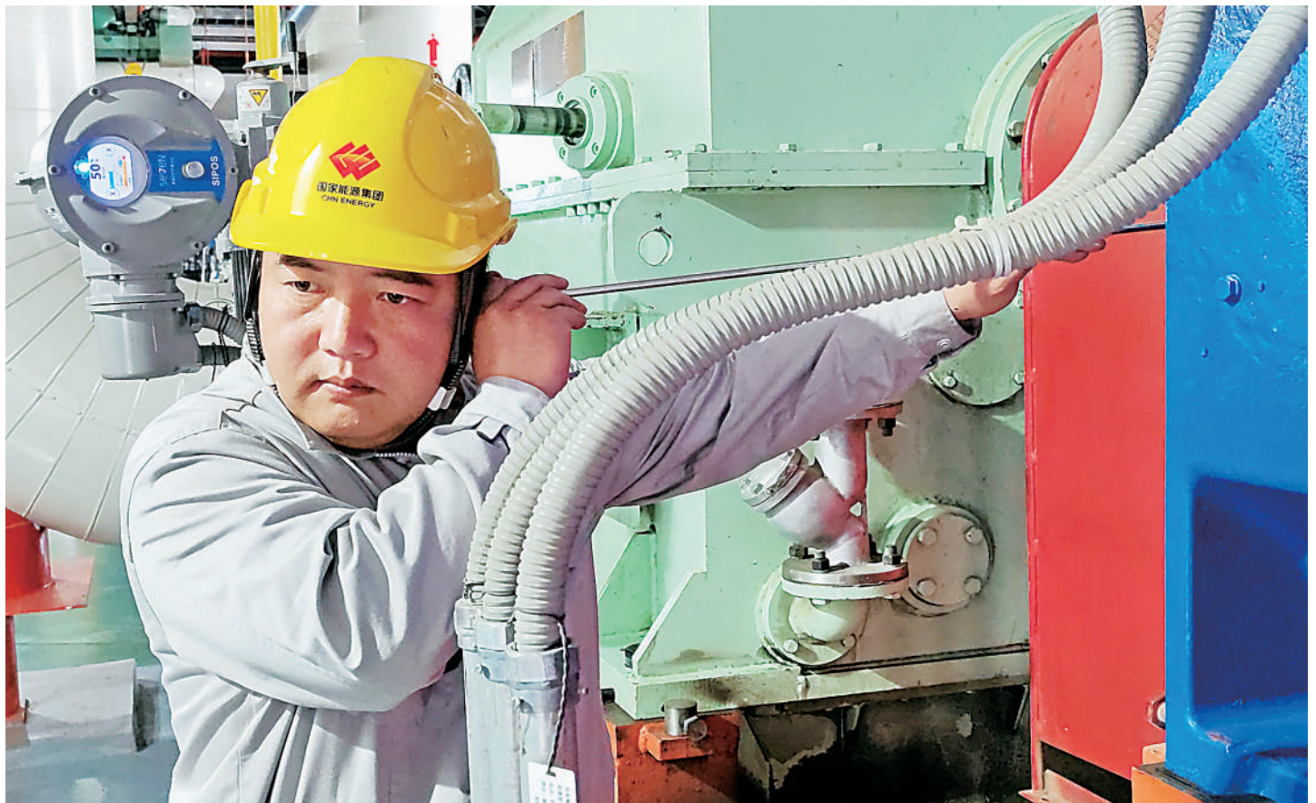
2月20日,国能宁夏灵武发电有限公司厂房内,工作人员在判断电动机运行中是否有异响。针对连日降雪冰冻天气,作为银川市“东热西送”唯一输出热源,担负着银川市7000多万平方米供热任务的国能宁夏灵武发电有限公司第一时间启动防雨雪冰冻应急响应,落实保电保供应急预案,全力保障能源稳定供应。 本报通讯员 张宗新 摄
