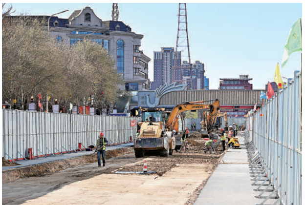
4月1日,银川市西夏区文萃北街(怀远路-贺兰山路)雨水管道工程加紧施工中。据了解,该项目投资2626万元,预计今年8月底前完工,项目建成后,将进一步完善片区雨水系统,补足内涝区域雨水排水设施,增强片区应对防汛排涝的能力。本报记者 王鼎 摄
