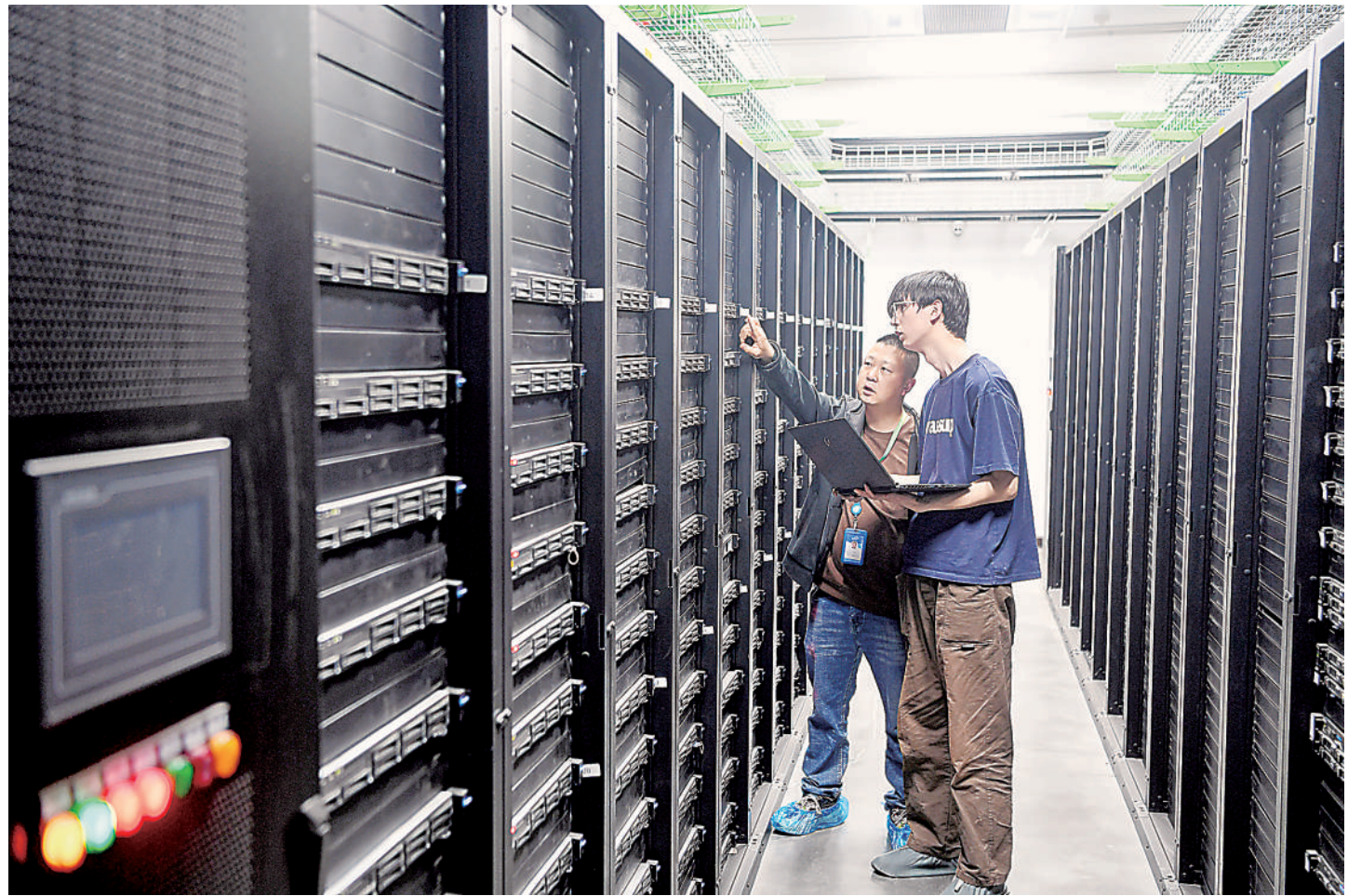
4月16日，宁夏西云算力科技有限公司运维人员在已经交付使用的新一代人工智能数据中心作业。今年初，宁夏智算中心项目一期工程——宁夏首个采用全自然风冷技术的30KW机柜人工智能数据中心在此落成，创新的直接新风自然冷却AHU方案大幅降低了常规制冷系统的风扇和压缩机功耗，降低碳排放，为国家“东数西算”工程“添绿”。
