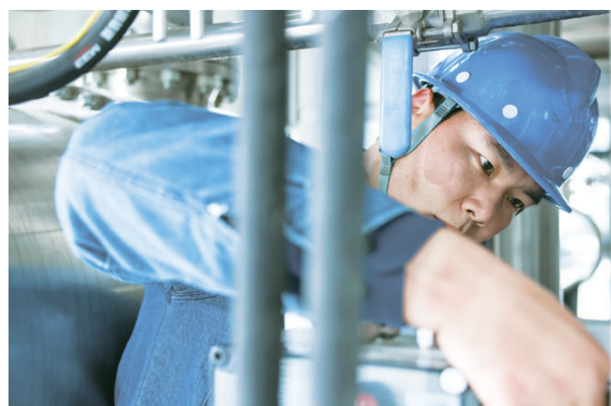
国家能源集团宁东可再生氢减排示范区一期项目现场,工人正在做准备工作。
