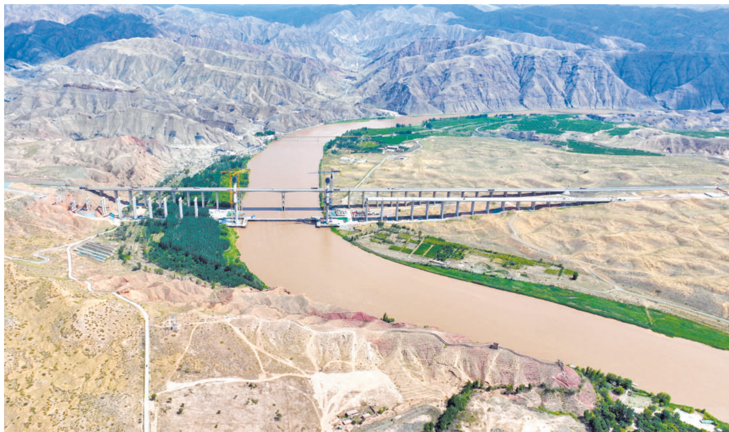
6月26日拍摄的沙坡头黄河公路大桥施工现场(无人机照片)。中卫市沙坡头黄河公路大桥全长1539米,为双塔双索面半漂浮体系钢混组合梁斜拉桥,塔高145米,双向4车道,设计时速80公里,是国道338线中卫至孟家湾段项目的重要控制性工程。新华社记者 袁宏彦 摄
