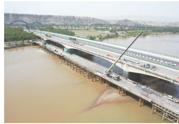
6月30日,中国铁建大桥工程局集团有限公司施工人员对1997年建成的中卫黄河大桥进行加固改造。此次加固改造工程预算投资1.035亿元,采用“塔塔斜拉组合体系+更换挂梁”方案,预计今年年底完工。本报记者 赵磊 摄
