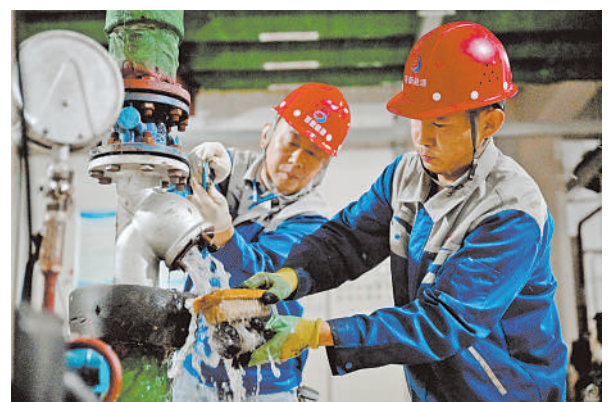
7月2日,维修工人在银川市闽海壹号院换站清洗管道过滤器。近日,宁夏百新能源科技发展有限公司在供热辖区内开展“冬病夏治”工作,为下一个采暖季做好准备工作。本报记者 左鸣远 摄
