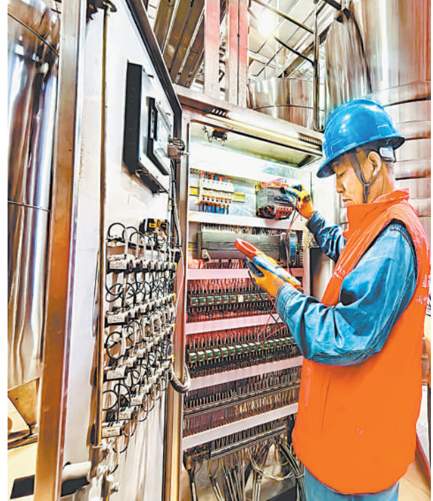
7月9日,国网宁夏电力有限公司贺兰县供电公司工作人员检查贺兰山东麓葡萄酒金山产区配电设施。入夏以来,国网贺兰县供电公司深入各大酒庄对用电设备进行“体检”,确保贺兰山东麓葡萄酒核心区域安全用电。
