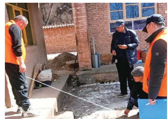
固原市利用居家和社区基本养老服务提升行动项目,为老年人进行适老化改造。
