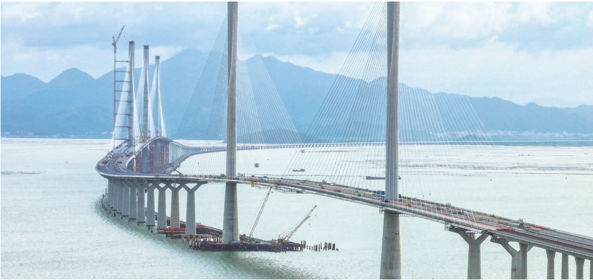
黄茅海跨海通道高栏港大桥(右)和黄茅海大桥(7月16日摄,无人机照片)。目前,中交路建承建的黄茅海跨海通道高栏港大桥已经进入索塔塔身涂装施工,被誉为海上“小蛮腰”的索塔单座涂装面积近万平方米。黄茅海跨海通道是粤港澳大湾区又一起大型跨海工程,连接珠海市和江门市,线路全长约31公里。跨海段由高栏港大桥和黄茅海大桥两座主桥组成,项目预计2024年年底通车。
