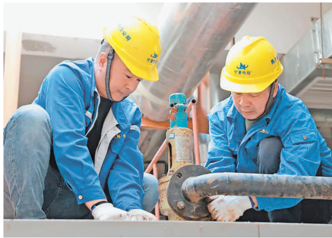
宁夏电力投资集团有限公司工作人员维护电力设施。
