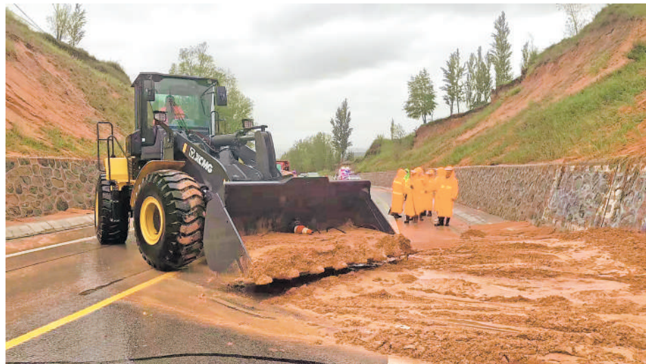
交通管理部门对公路进行隐患排查整治。(图片由受访者提供)
